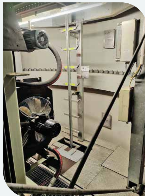
Góndola del Parque Eólico Qollpana
