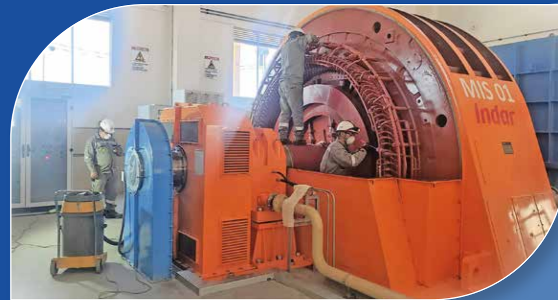
Mantenimiento mayor de la Unidad Generadora N° 1 de la Central Hidroeléctrica Misicuni
