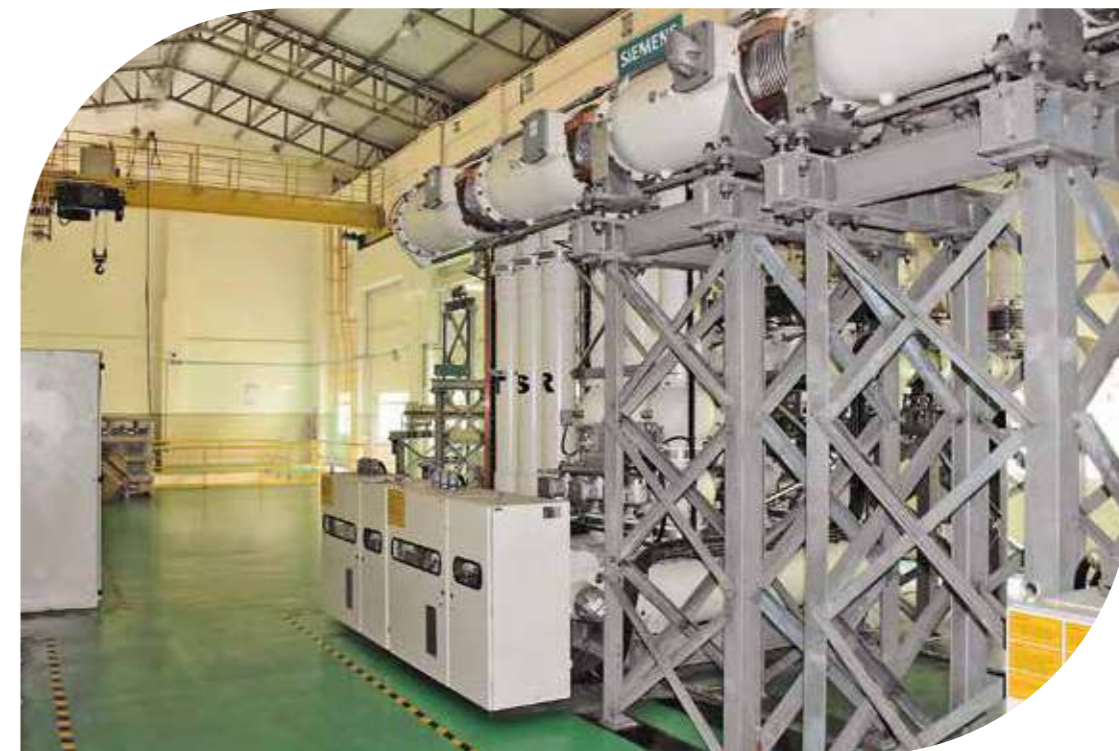
Subestación GIS de la Central Hidroeléctrica San José 2
