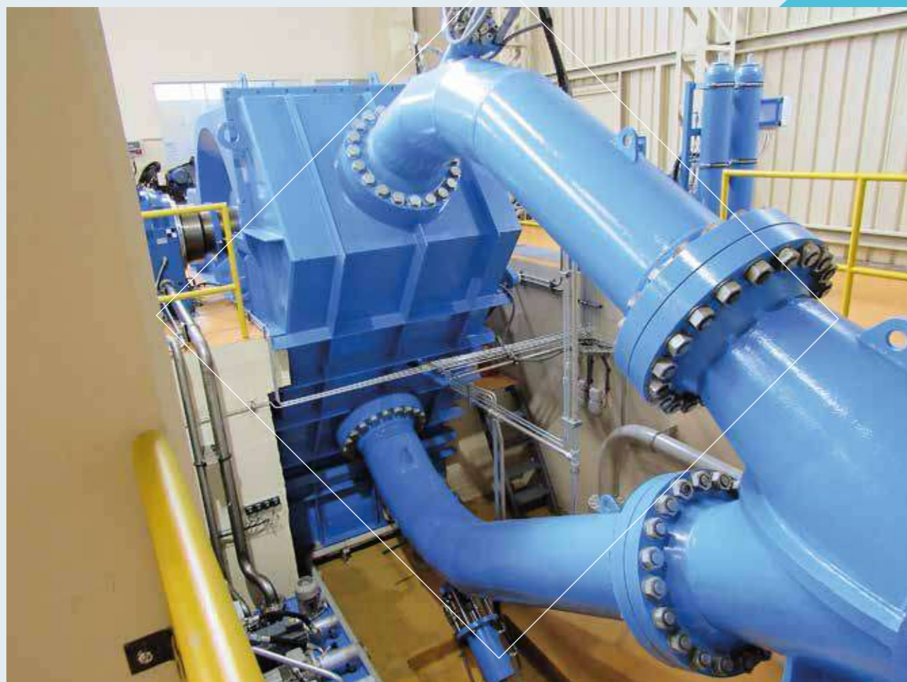
Vista de las tuberías de conducción a los inyectores de la unidad 05 de la Central Hidroeléctrica Corani
