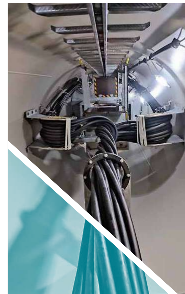
Vista interna del enroscamiento de los cables de potencia de los aerogeneradores
