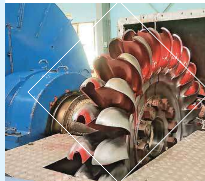
Trabajos de tinta penetrantes en rodete Pelton de la Central Hidroeléctrica Santa Isabel
