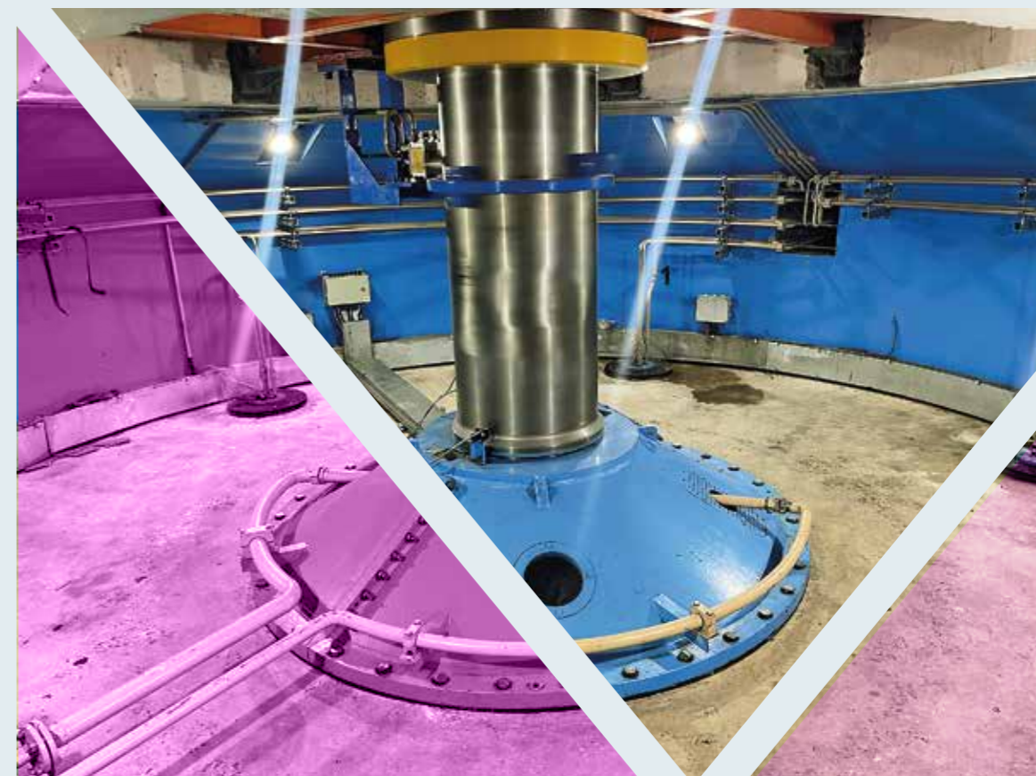
Vista del eje de los generadores de la Central Hidroeléctrica San José 1
