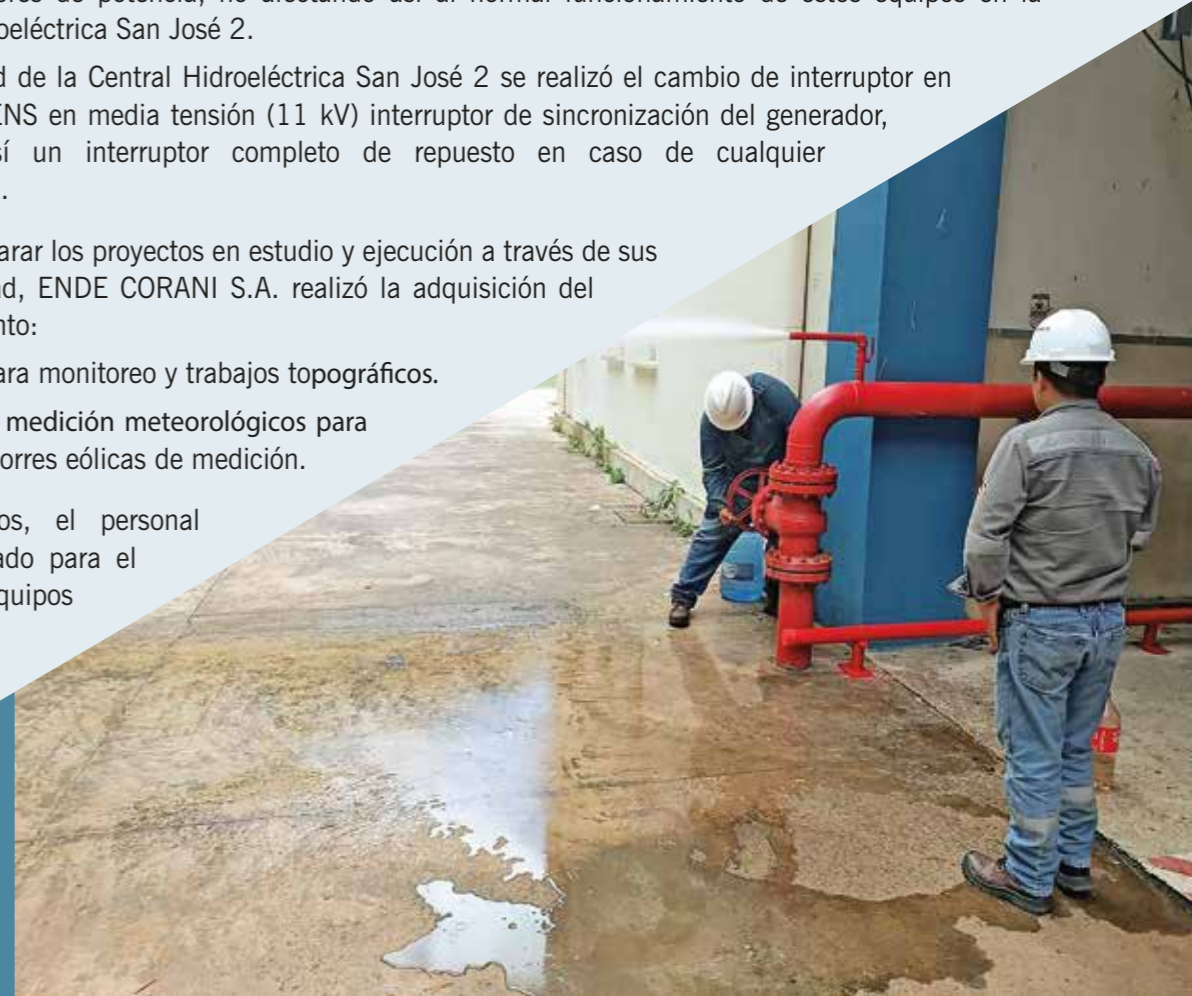
Mantenimiento preventivo del sistema de protección contra incendios de la Central Hidroeléctrica San José 2
