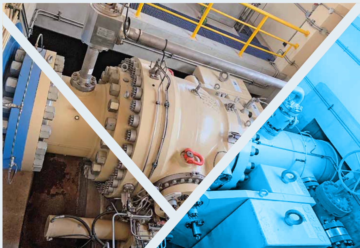
Vista de la válvula esférica de la unidad MIS03 de la Central Hidroeléctrica Misicuni
