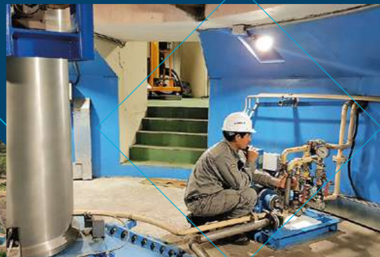
Inspección del sistema de lubricación de la Central Hidroeléctrica San José 1
