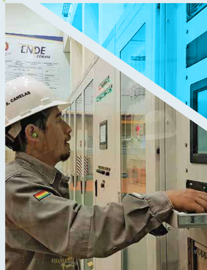
Inspección del regulador de velocidad de la Central Hidroeléctrica San José 1
