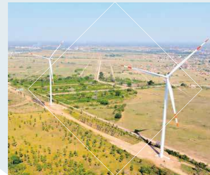
Vista aérea de los aerogeneradores del Parque Eólico Warnes I
