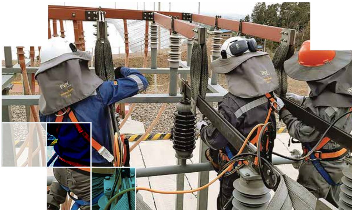
Mantenimiento preventivo de barras de media tensión (Central Hidroeléctrica Misicuni)
