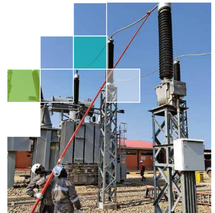
Aplicación de medidas de seguridad para mantenimiento de subestación (Parque Eólico El Dorado)
