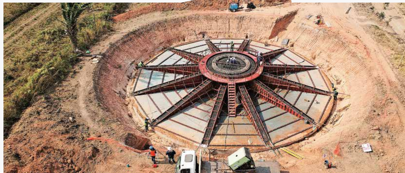
Cimentación con encofrado para vaciado de hormigón de segunda fase (pedestal para torre de aerogenerador) en el Parque Eólico Warnes
