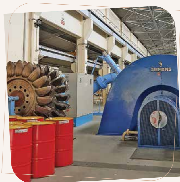
Casa de Máquinas de la Central Hidroeléctrica Corani
