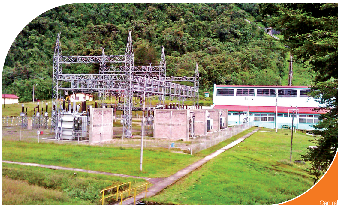
Central Corani Sub estación
