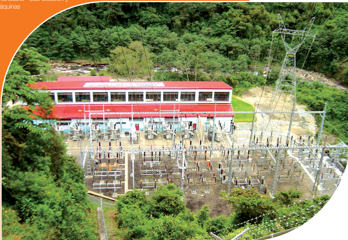
Central Santa Isabel - Sub estación y Casa de Máquinas
